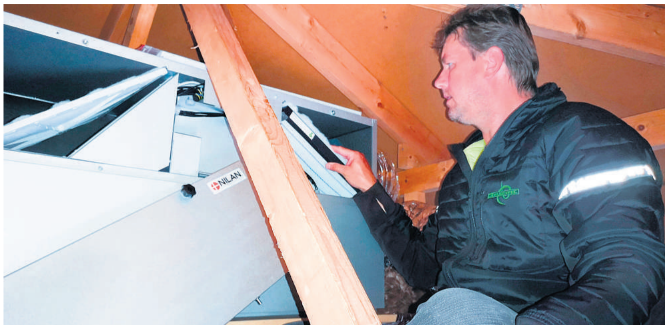
Per Christensen er gået på loftet for at tjekke, at anlægget virker. Det gør det. Foto: Lars Juul
